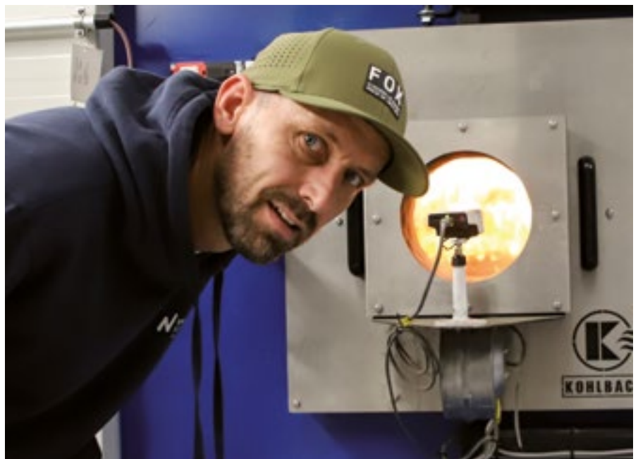
Denny Schulte, Meister Energieerzeugung, hat den Heizkessel hochgefahren.
