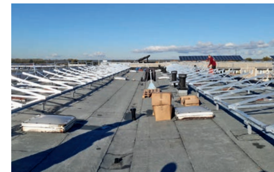
■ Der Ausbau der Solarthermie trägt zur Einsparung primärer Energie ein und verbessert die Klimabilanz.
