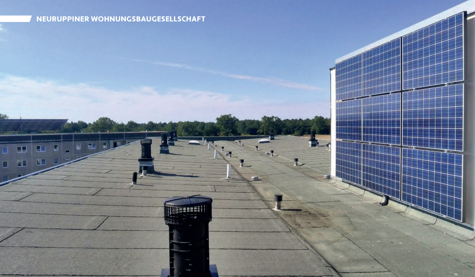
■ Saft vom Dach: Auf zahlreichen Häusern der NWG sind Solaranlagen zu finden.
